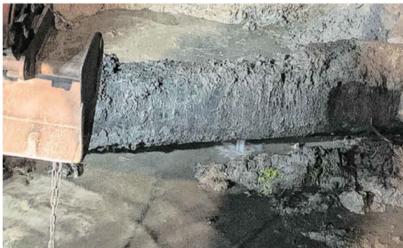
Der Schaden ist lokalisiert. Aus der gerissenen Transportleitung fließt das Trinkwasser heraus.
