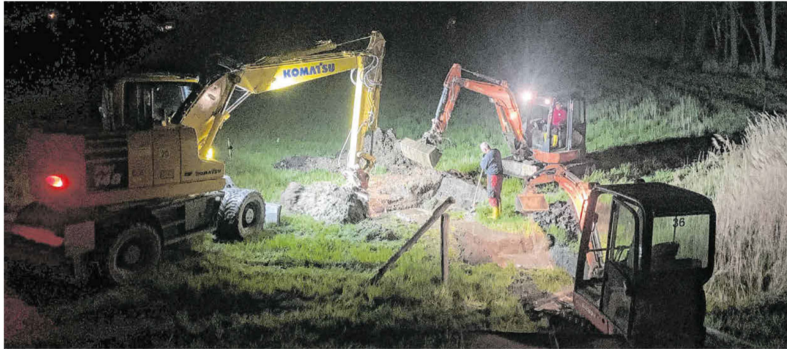
Mit zwei Baggern ist die Schadstelle der Trinkwasserhauptleitung am Röderkanal bei Würdenhain in der Nacht zum Montag geöffnet worden. Die Leitung verbindet das Wasserwerk Oschätzchen mit dem Raum Elsterwerda. Fotos: Maik Hauptvogel
