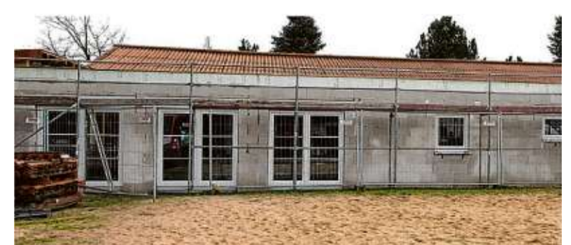
Die Hoffnung ist groß, dass das Gebäude spätestens Ende des Sommers fertiggestellt ist. Foto: Lars Bobach
